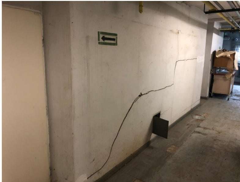
Spękana ściana osłonowa szachtów w komunikacji.
