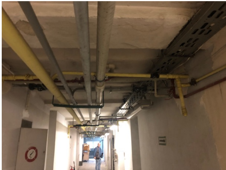
Instalacje istniejące prowadzone pod stropem w komunikacji.
