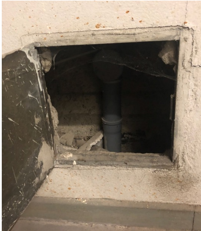
Pion kanalizacji sanitarnej w szachcie technicznym
