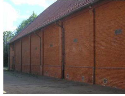
Ryc.31. Kanały nawiewne i wywiewne w budynku inwentarskim siatki ograniczające wchodzenie gryzoniom.
