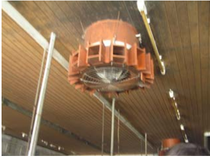
Ryc.30. Odpowiednio zabezpieczony wentylator – siatka osłaniająca elementy wirujące.
