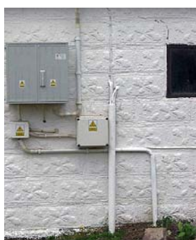
Ryc. 38. Właściwie zabezpieczone i oznakowane instalacje elektryczne [71]
