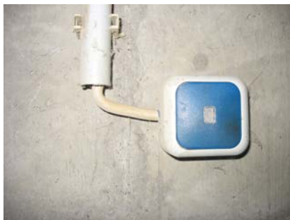
Ryc.32. Włącznik oświetlenia z podświetleniem. [Fot. E. Marciniak]
