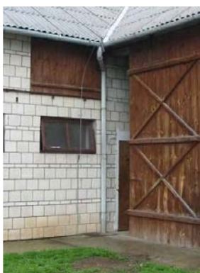
Ryc.40. Fragment instalacji odgromowej [69]
