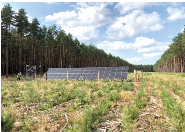
Zestaw paneli słonecznych dostarczających energię elektryczną do stacji Sarbia
